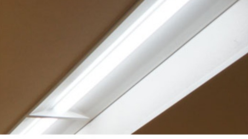
<ホールのLED灯>
